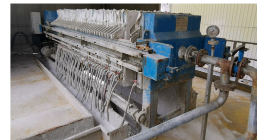
废水废浆压滤机
