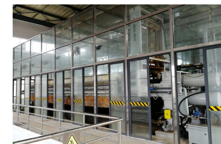
污泥深度脱水设备—板框压滤机
