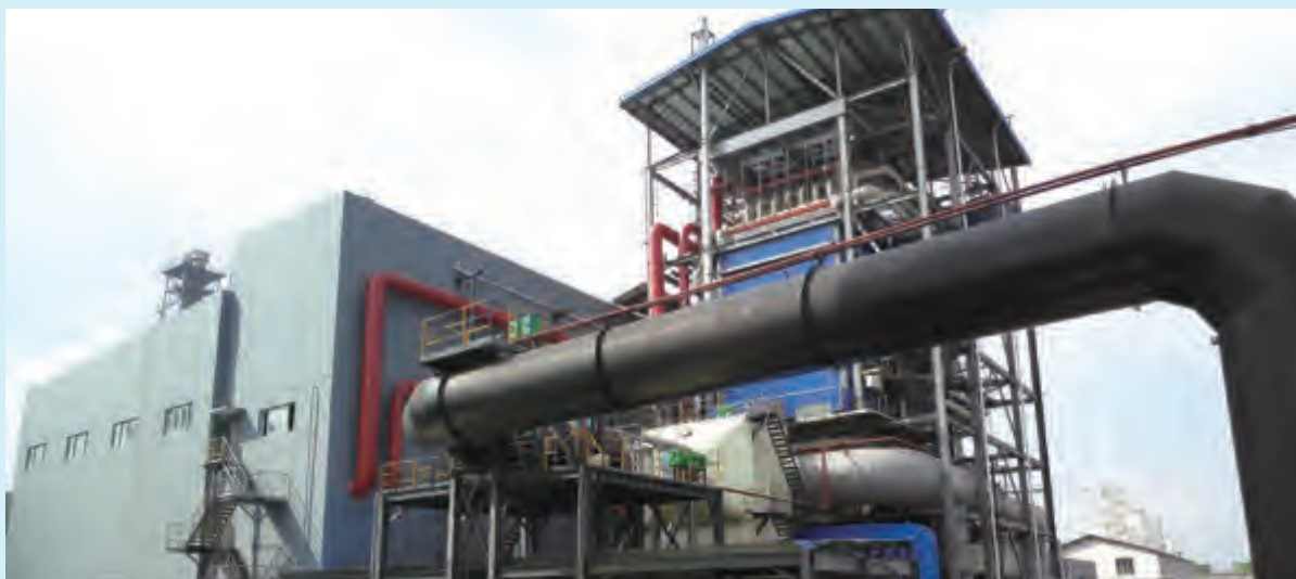
广西盛隆煤气发电现场全貌
